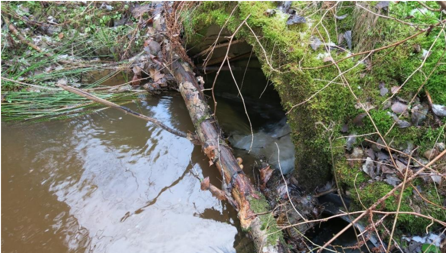
Bild 1. Vägtrumman vid Prästbol före åtgärder. Inloppet.
