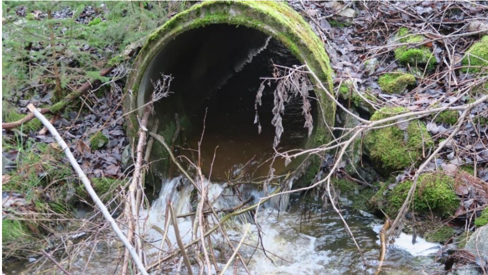
Bild 5. Vägtrumman vid Klockaredalen före åtgärder. Utloppet.
