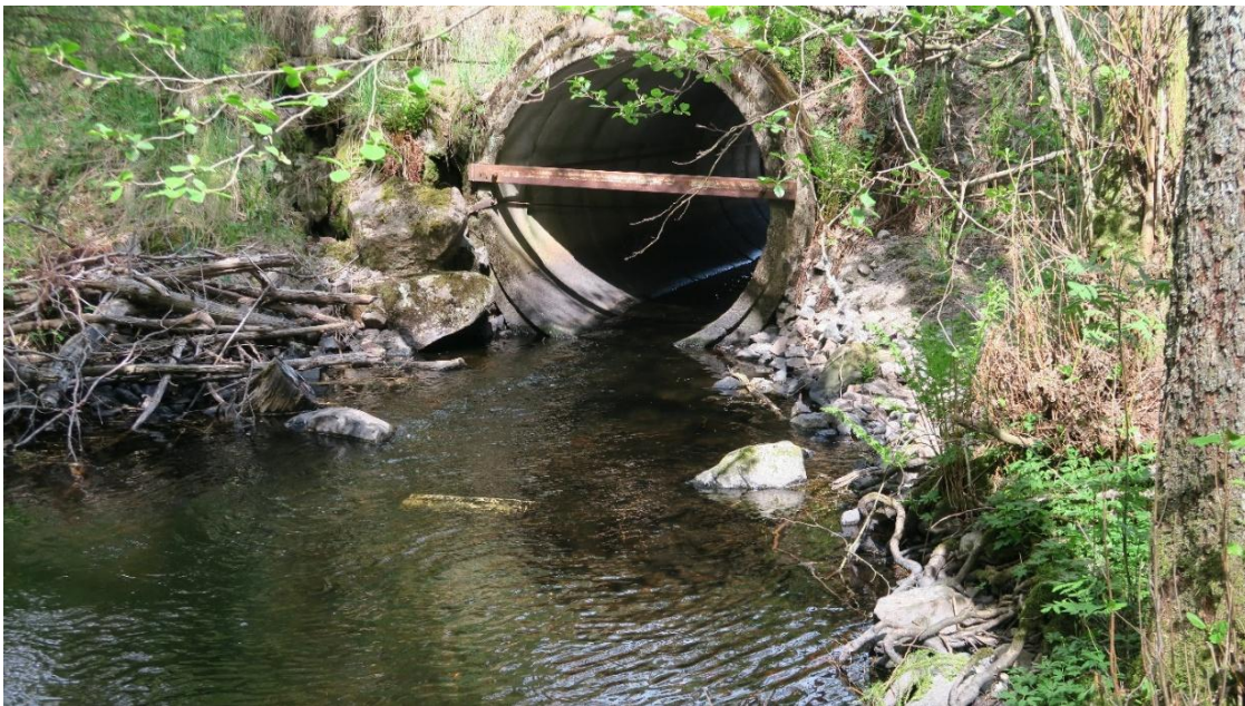
Bild 16. Vägtrumman i Fällälven vid Pipevägen år 2020 (hinder D1). Vägtrumman åtgärdades som vandringshinder 2017, då en tröskel anlades nedströms och bäckbotten höjdes så att stalpet (fallet i utloppet) togs bort.
